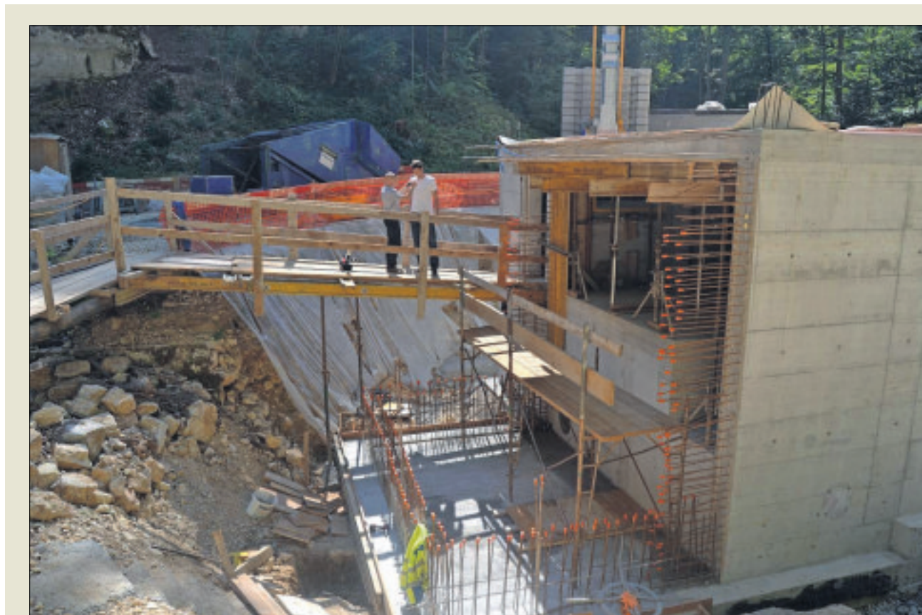
Que les amoureux de la nature se rassurent: le bloc de béton sera intégré dans une butte. PHOTO OZA
