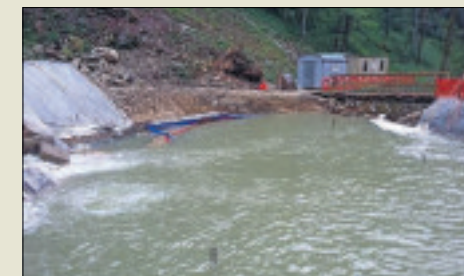
Chantier inondé lors de la crue du 1 er mai. Le débit de la Foule peut dépasser les 60 000 litres/minute.
