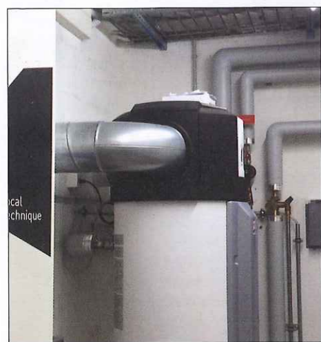
Les besoins annuels de chauffage s'élèvent à 50 000 kWh pour environ 3200 m 2 de surface nette sur quatre niveaux. La PAC est alimentée par 18 sondes géothermiques de 80 mètres chacune. Puissance de 56,5 kW.
