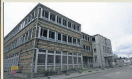
Le mur nord vient de tomber. Le bâtiment administratif suivra.
